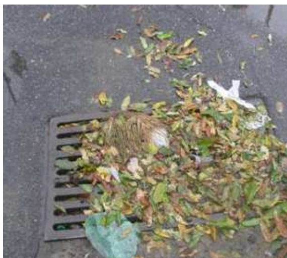
Figura 4. – Obstrução de uma boca de lobo próxima ao Mergulhão devido às folhas
